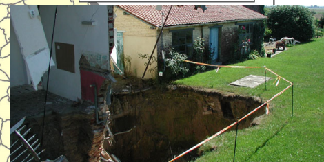
Effondrement d'une cavité souterraine
